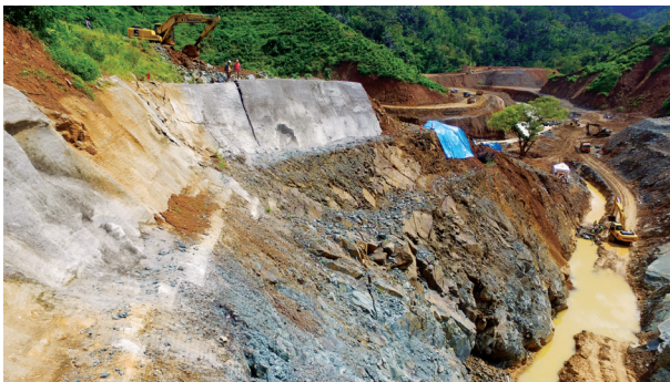
► Foto kondisi Inlet Terowong Pengelak Pada Bulan Januari 2016 Kondisi geologi yang terdapat banyak crack (sangat intensif) menyebabkan runtunan – runtunan kecil sangat sering terjadi, dan dapat memicu terjadinya reruntuhan besar.
